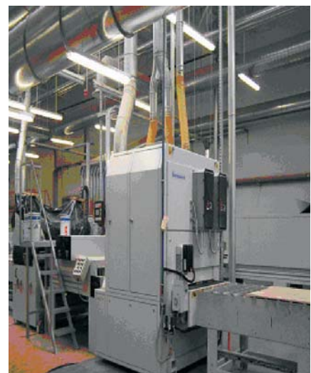
Fot. 8. Obrabiarka w kabine dźwiękochłonnej z odpylaniem
