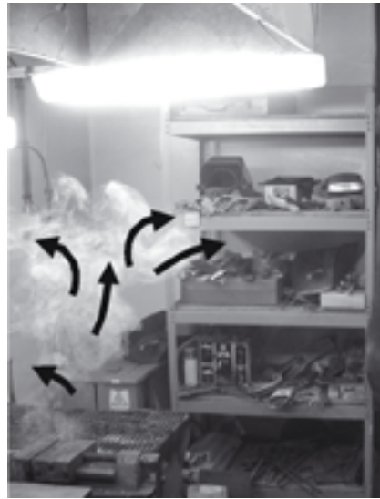
Fot. 1. Wizualizacja przepływu dymu na stanowisku pracy w badanym pomieszczeniu, gdy system wychwytywania zanieczyszczeń był wyłączony
