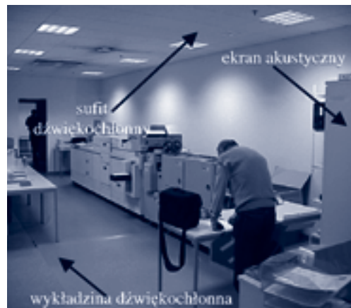
Rys. 7. Widok technicznego pomieszczenia biurowego – drukarni z elementami zabezpieczeń przeciwhałasowych [1]
