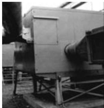
Obudowa dźwiękochłonna-izolacyjna wentylatorów i filtrów F10; konstrukcja samonośna z segmentów dźwiękochłonna-izolacyjnych o grubości 105 mm; ściany wykonane z blachy stalowej, folii dźwiękoizolacyjnej, płyty z wełny mineralnej oraz z blachy perforowanej
